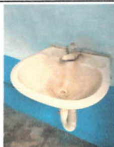
Foto 5: SERVICIOS SANITARIOS Y SUS ACCESORIOS
