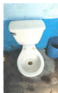
Foto 4: SERVICIOS SANITARIOS Y SUS ACCESORIOS
